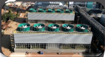
TORRES DE ENFRIAMIENTO SPIG
